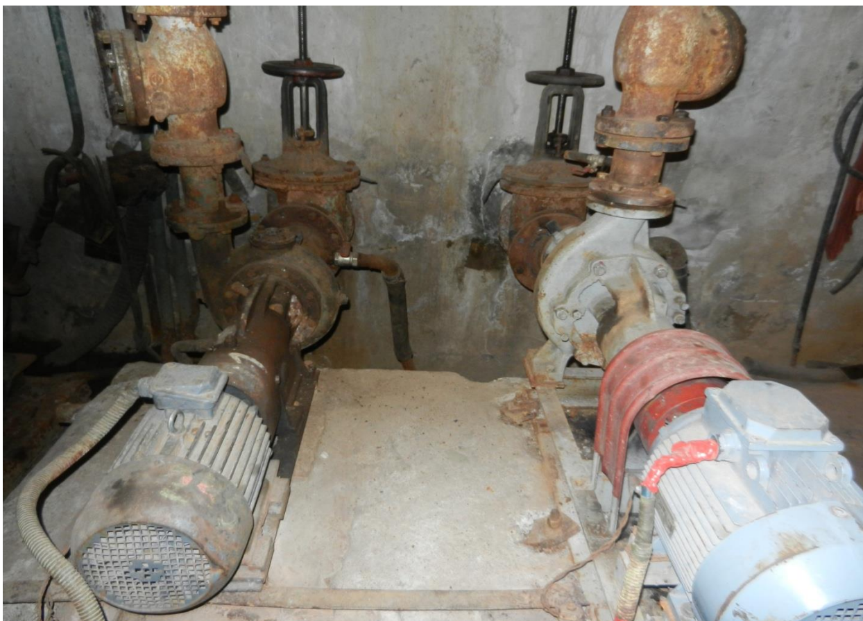
Рис. 17. Канализационная насосная станция №5. Состояние насосов.
