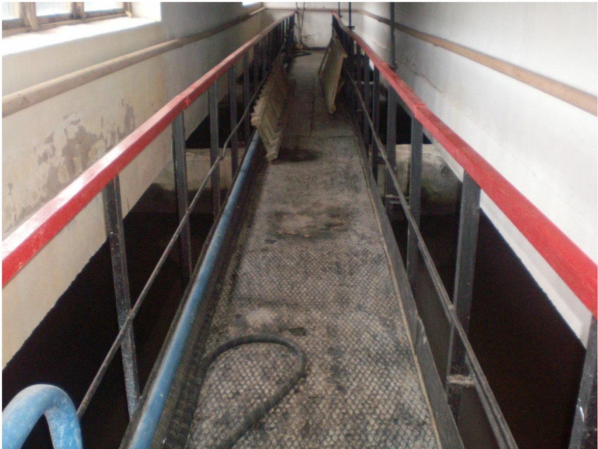
Рисунок 24. Водоочистные сооружения на р. Плюсса. Горизонтальный отстойник с камерой хлопьеобразования.
