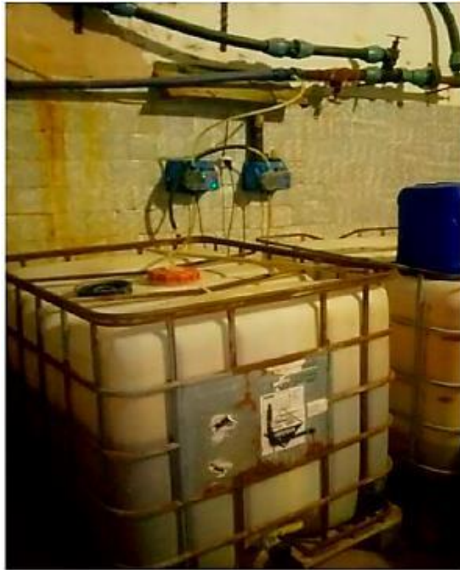
Рисунок 30. Водоочистные сооружения на р. Плюсса. Установка дозирования гипохлорита натрия.
