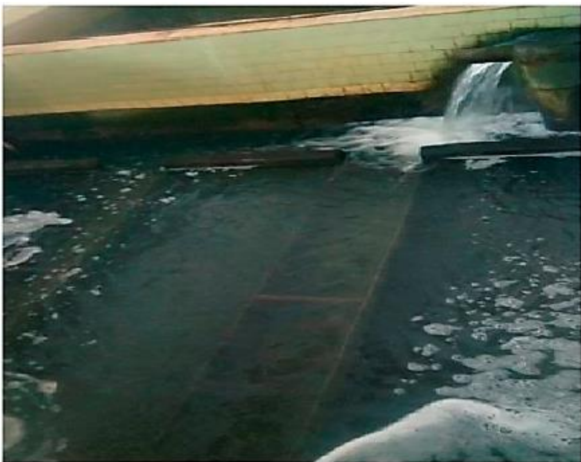
Рисунок 26. Водоочистные сооружения на р. Плюсса. Скорые фильтры.
