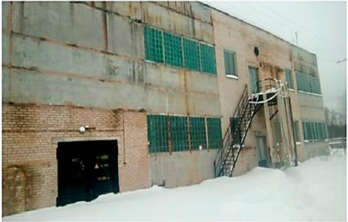
Рисунок 28. Водоочистные сооружения на р. Плюсса. Здание НС II-го подъема.
