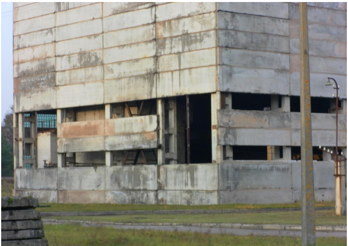
Рисунок 31. Водоочистные сооружения на р. Плюсса. Недостроенный цех обработки осадка.
