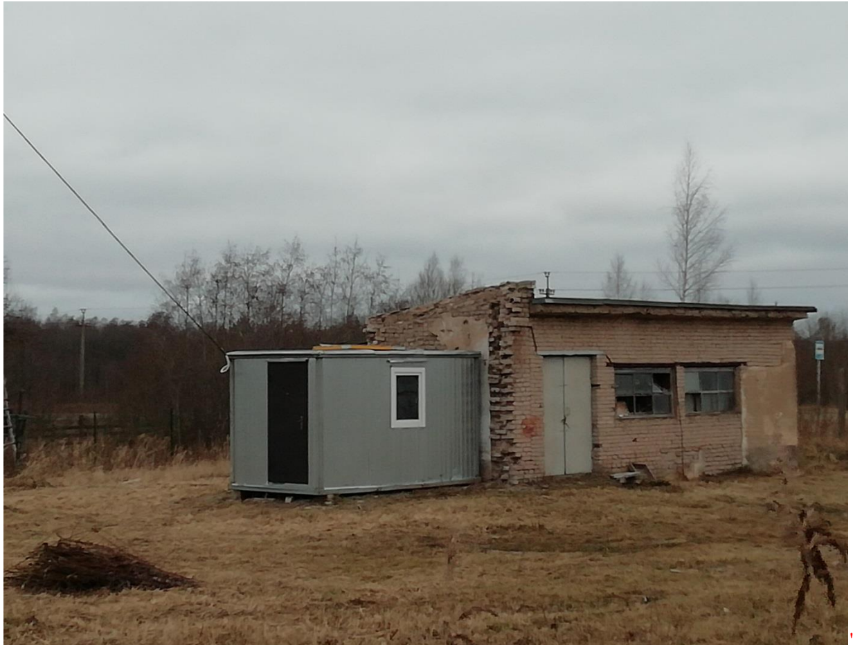
Рисунок 15. Водозаборные сооружения д. Каменка (скважина №10338/ ).
