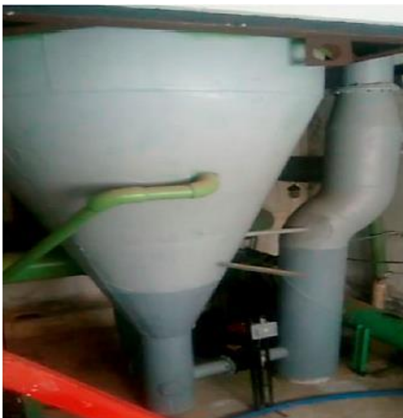
Рисунок 22. Водоочистные сооружения на р. Плюсса. Вихревой смеситель (нижняя часть).
