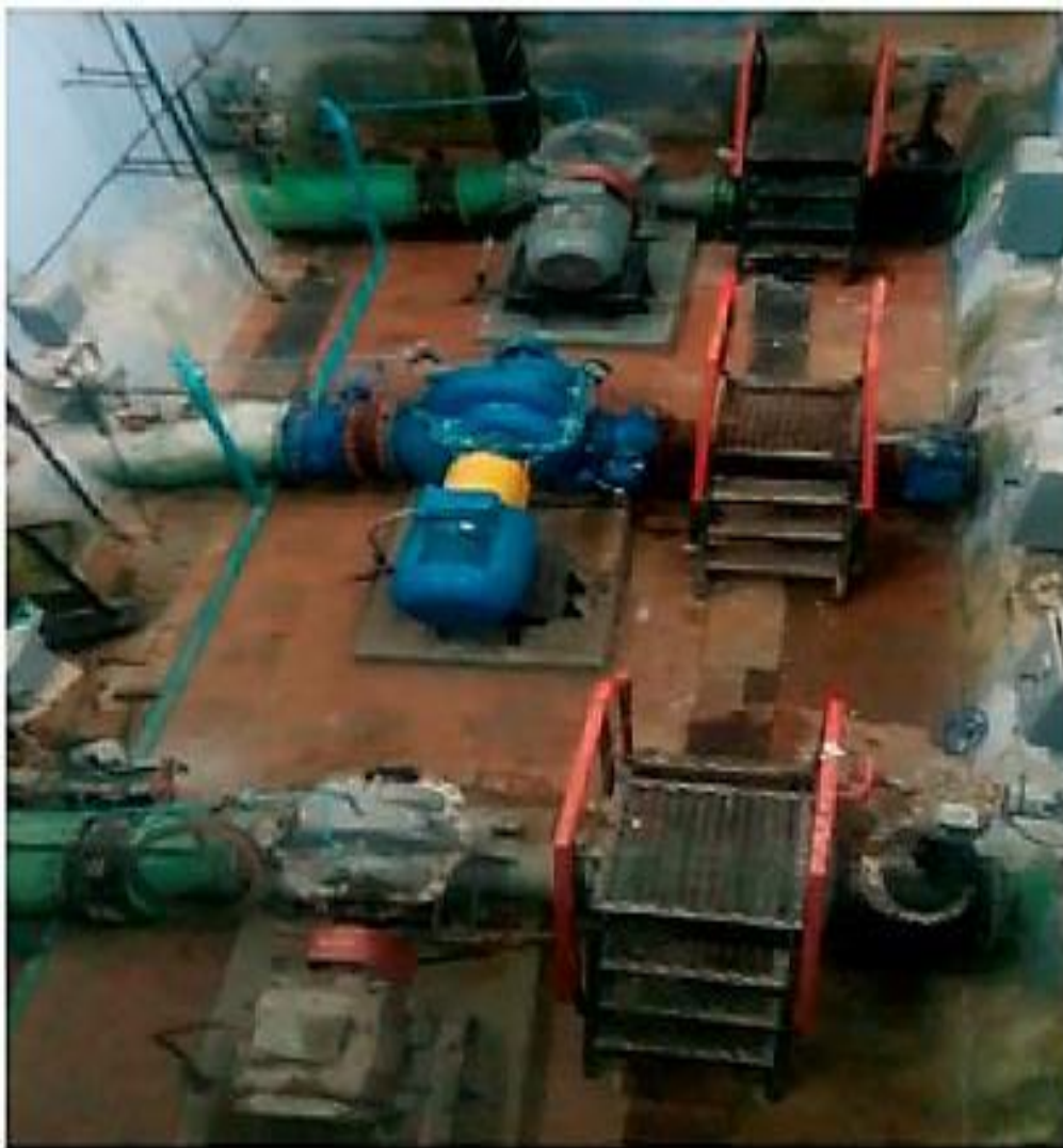
Рисунок 11. Водозаборные сооружения на р. Плюсса. Машинный зал насосной станции I-го подъема.
