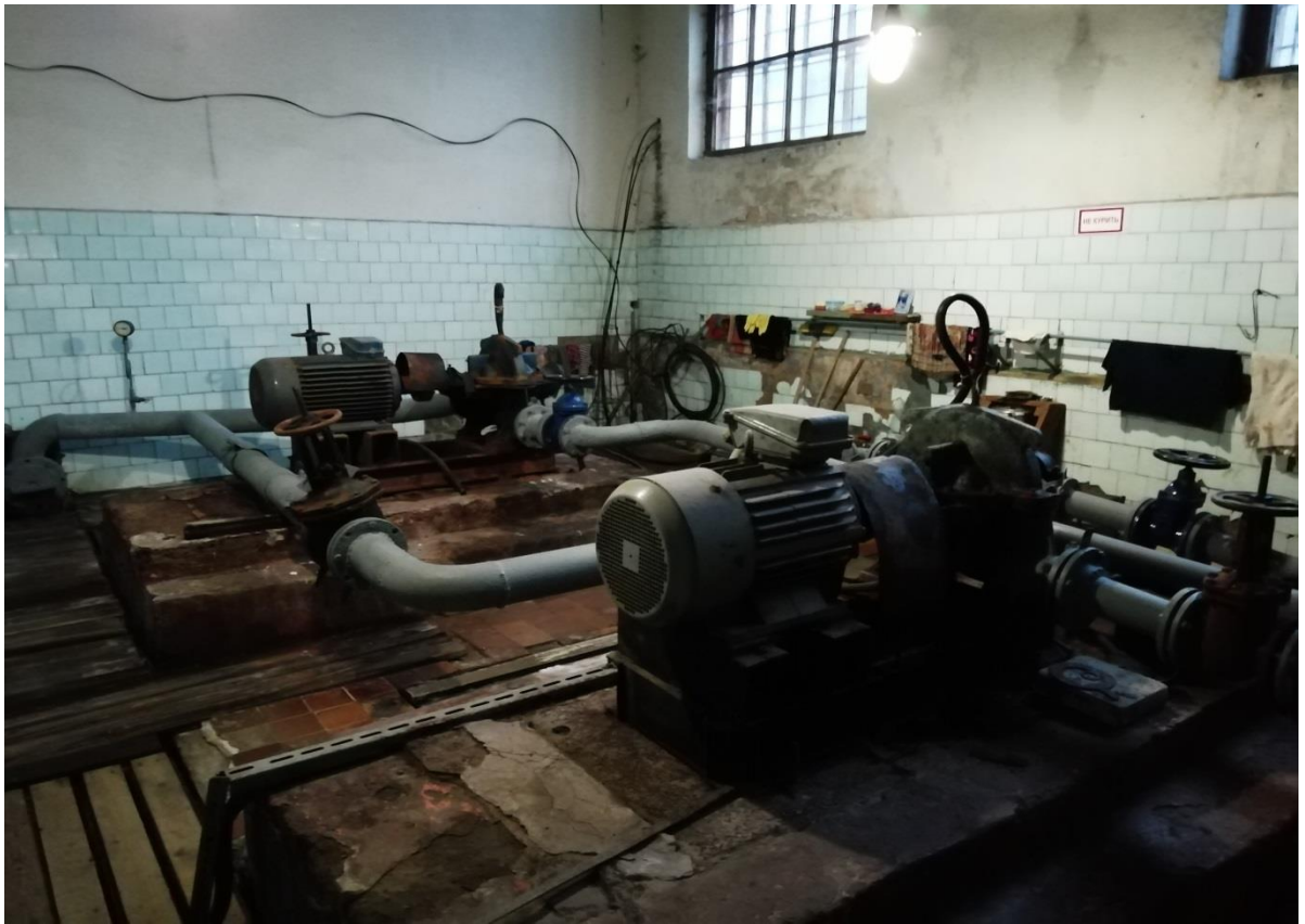
Рисунок 36. Машинный зал насосной станции III-го подъема ВНС №1.
