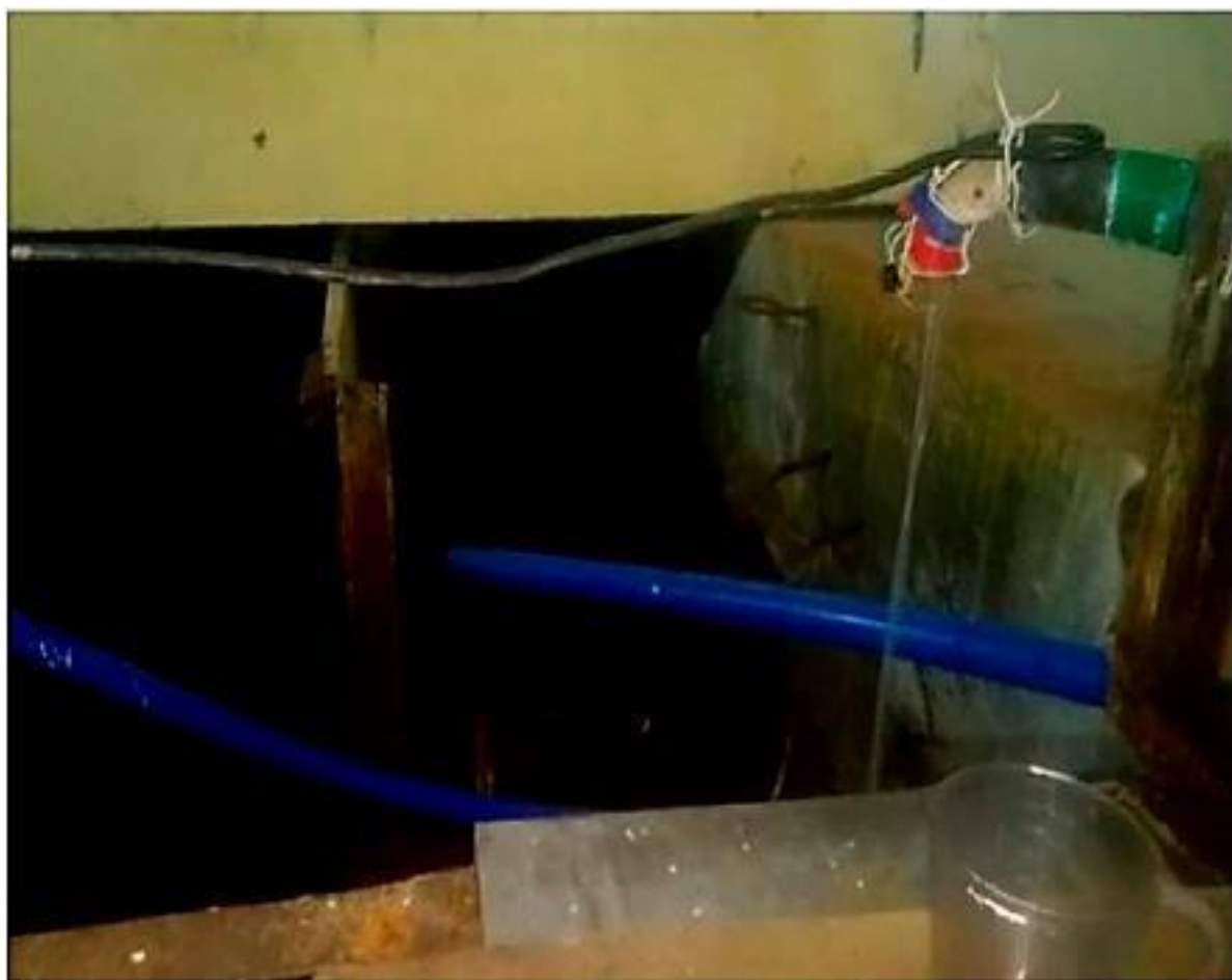
Рисунок 23. Водоочистные сооружения на р. Плюсса. Контактная камера.
