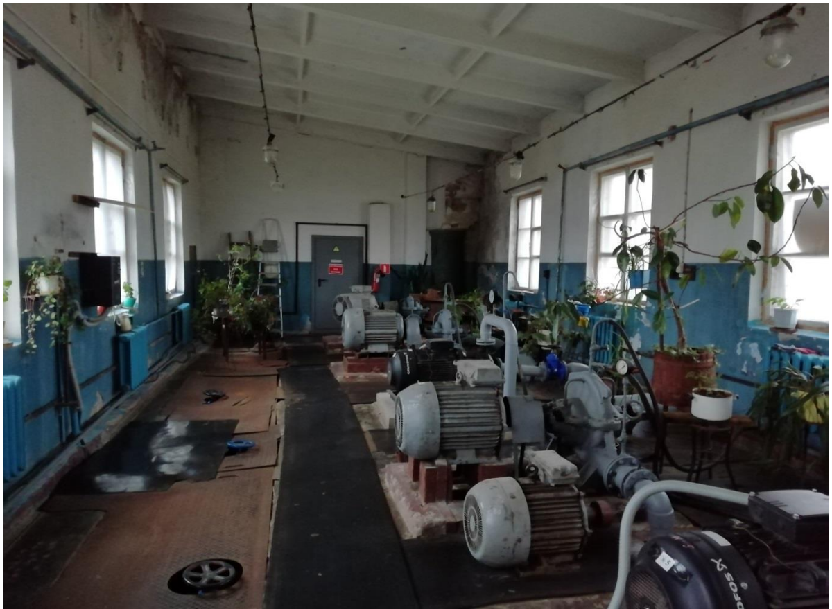
Рисунок 38. Машинный зал насосной станции III-го подъема ВНС №2.
