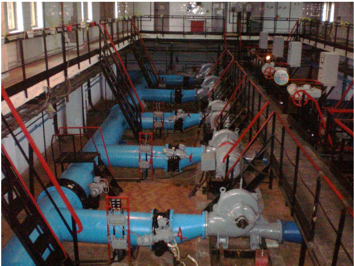
Рисунок 29. Водоочистные сооружения на р. Плюсса. Машинный зал НС II-го подъема.
