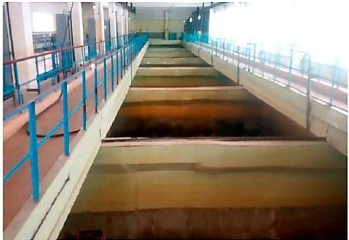
Рисунок 25. Водоочистные сооружения на р. Плюсса. Фильтровальный зал.
