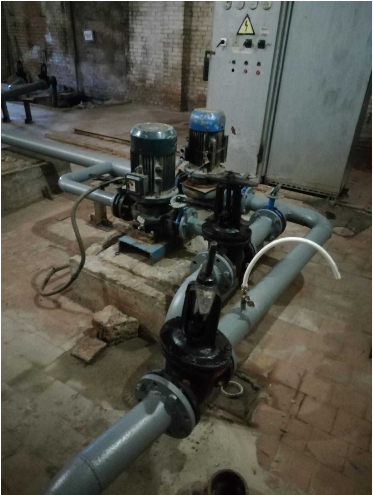
Рисунок 43. Машинный зал ПНС ул. Шахтерской Славы, д. 9б.
