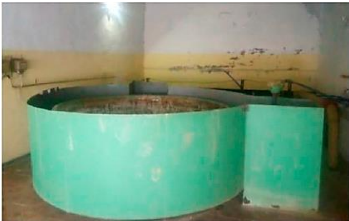
Рисунок 21. Водоочистные сооружения на р. Плюсса. Вихревой смеситель (верхняя часть).
